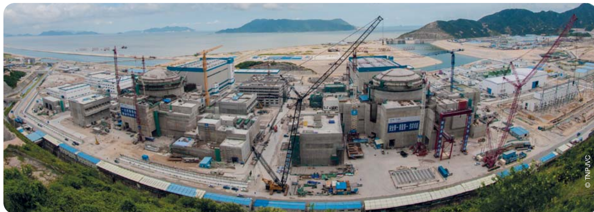
图片是2014年8月中国广东台山核电1&2号机组EPR反应堆施工现场
